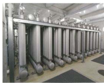
ありあけ浄水場(膜ろ過装置)
