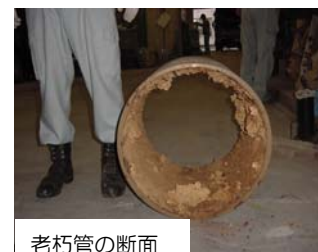
老朽管の断面
