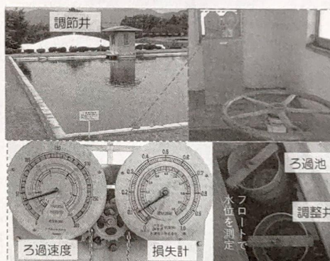
図13 調節井の損失と流量は機械的に計測
